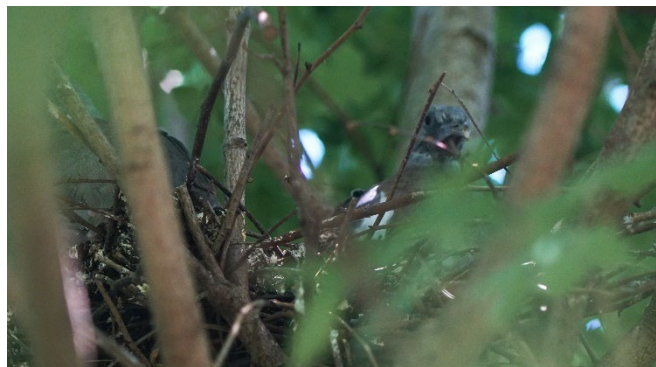
Pigeons ramiers au nid dans le bois de la toiture – AH juillet 2019
